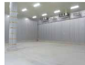
KSパワーパネル
